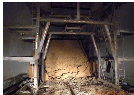
图2 隧道洞内塌方 Fig.2 Tunnel collapse
